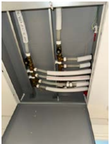
Samleskap med rørkurser og stoppekraner
