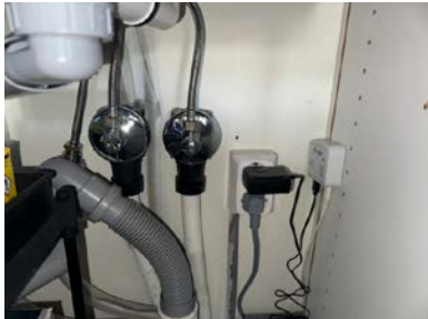
Røropplegg i kjøkkenbenk med Waterguard
