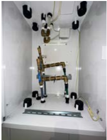
Samleskap med rørkurser og stoppekraner
