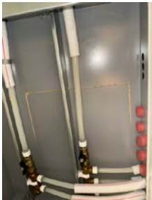
Samleskap med rørkurser og stoppekraner
