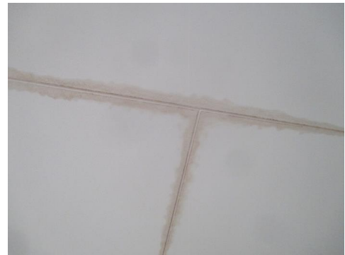
Eldre fuktmerker på himling på kjøkken.
