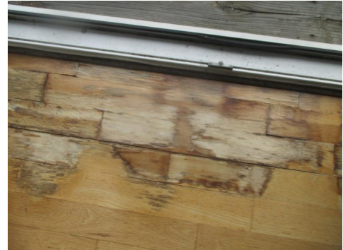
Større fuktskade på parkett ved balkongdør.
