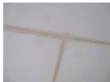
Eldre fuktmerker på himling på kjøkken.
