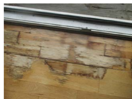
Større fuktskade på parkett ved balkongdør.
