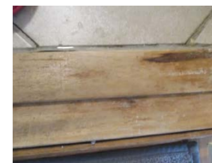
Vannet har rent i mot dørterskel.
