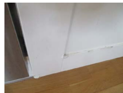
Noe skader på skapdør under vask.
