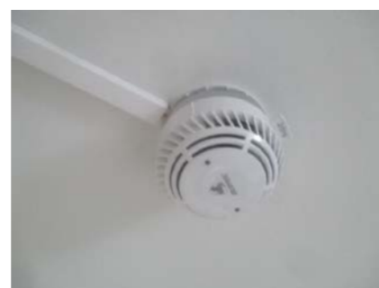
Felles vaslingssystem i bygget.
