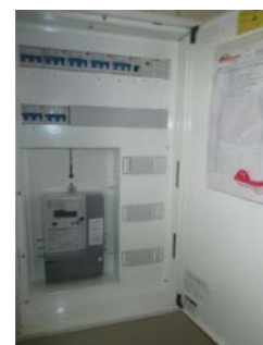
Sikringsskapet er plassert i vindfang.
