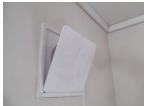
Ventiler i yttervegger.
