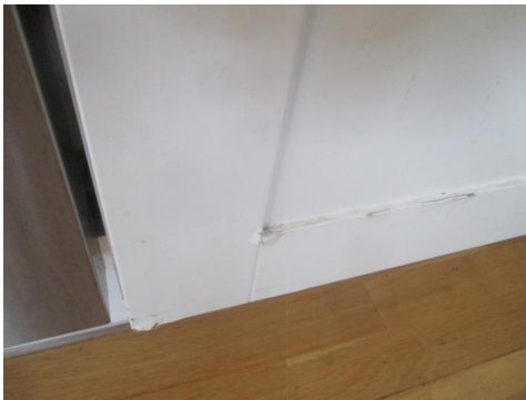
Noe skader på skapdør under vask.
