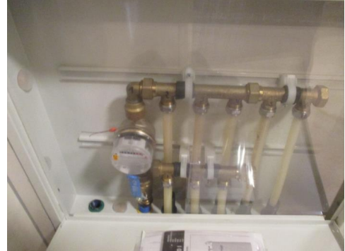
Fordelerskapet er plassert på bad/vaskerom.
