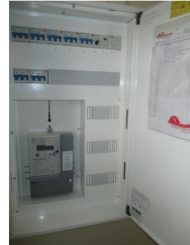
Sikringsskapet er plassert i vindfang.
