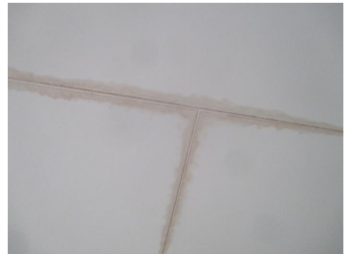
Eldre fuktmerker på himling på kjøkken.
