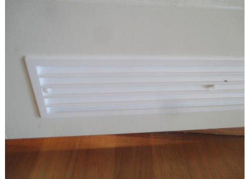
Luftventil i dør.
