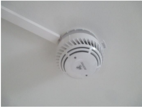
Felles vaslingssystem i bygget.
