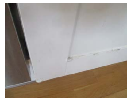
Noe skader på skapdør under vask.
