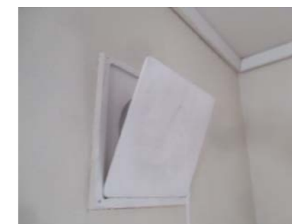
Ventiler i yttervegger.
