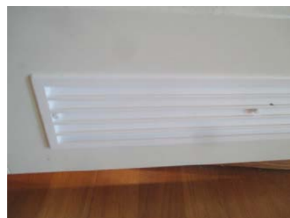
Luftventil i dør.
