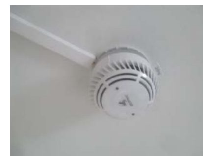
Felles vaslingssystem i bygget.
