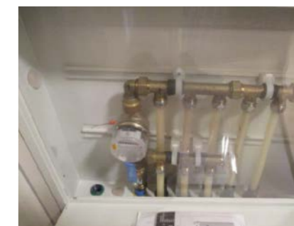
Fordeleskapet er plassert på bad/vaskerom.
