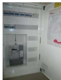
Sikringsskapet er plassert i vindfang.
