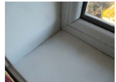
Foring har svellet noe på loftstue.
