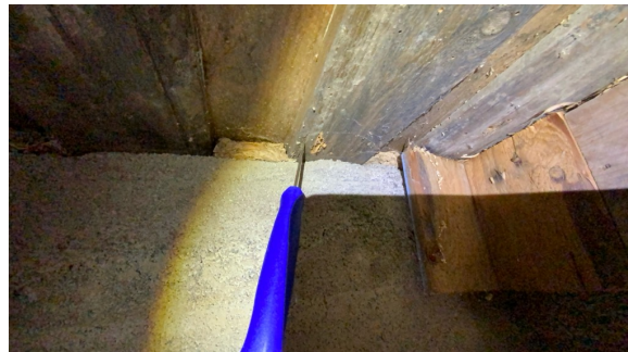
Råteskade i bord
