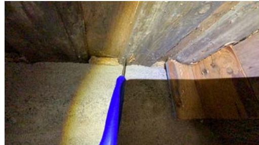
Råteskade i bord
