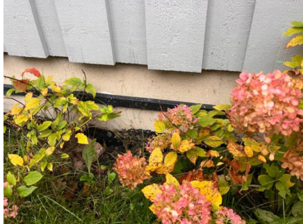
Topplister dekker ikke topp på vorteplast.
