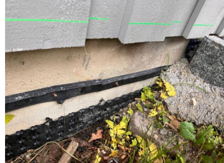
Vann fra terrasse kan renne inn bak vorteplasten
