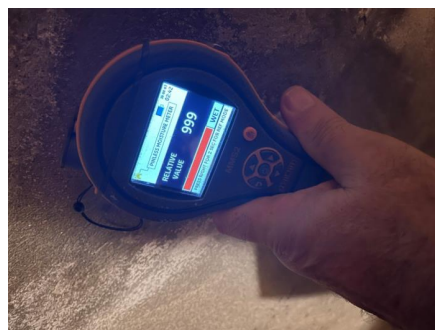
Synlig fukt på sørøst side i grunnmur.
