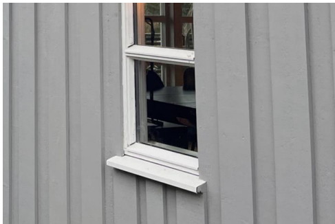
Omramming ned mot vannbrett, noe malingslitt utvendig.
