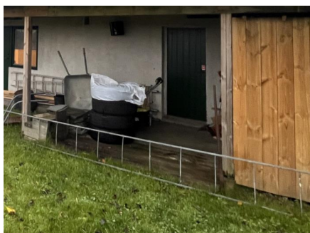
Platting foran ytterdør til bod.
