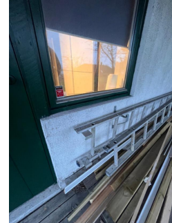
Utsparing i grunnmur under vindu har ikke fall ut fra vinduet.
