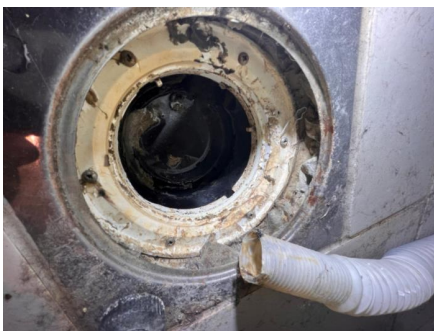
Sluk under dusjkabinett
