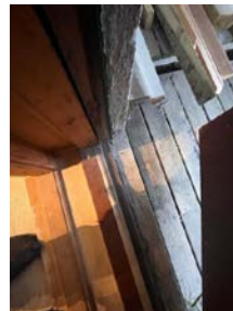
Slitte/manglende pakninger på dør på soverom.
