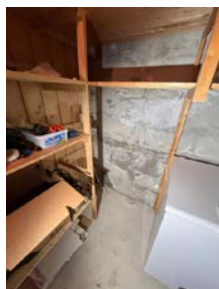
Synlig fukt på sørøst side i grunnmur.
