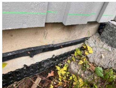
Vann fra terrasse kan renne inn bak vorteplasten
