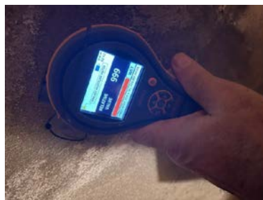
Synlig fukt på sørøst side i grunnmur.
