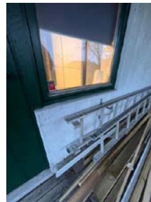
Utsparing i grunnmur under vindu har ikke fall ut fra vinduet.
