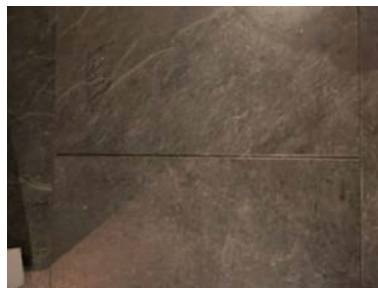
Sprekker i skjøter på kjøkken gulv.
