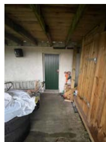
Ytterdør bod, slitte pakninger og bunn på karmen.
