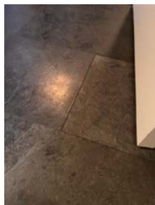
Sprekker i skjøter på kjøkken gulv.
