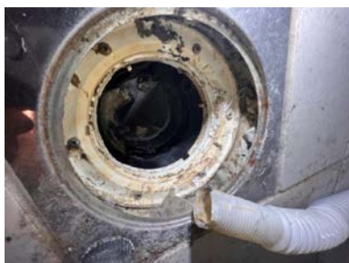
Sluk under dusjkabinett
