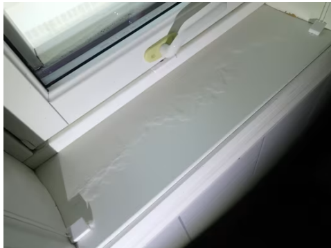
Fuktskade i foring
