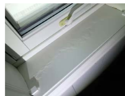
Fuktskade i foring
