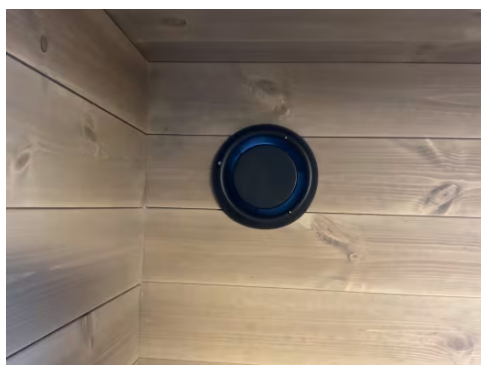
Ventil i vegg.
