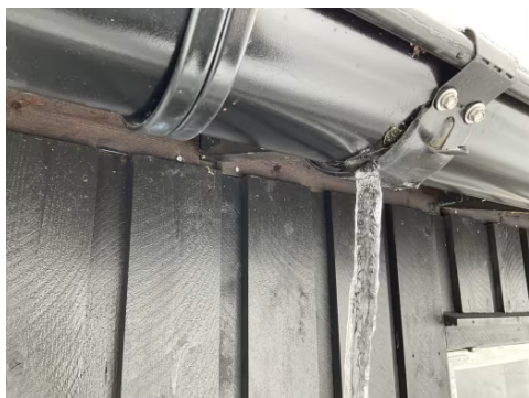
Skade i takrenneskjøt.
