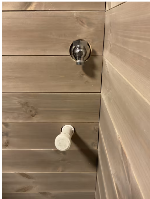
Manglende tetting rundt rør.
