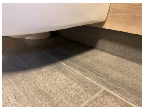
Manglende drengåpning for lekkasjevann fra wc.
