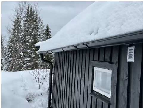
Nedbøy i takrenne.
