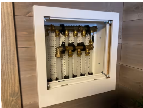
Fordelerskap til vann.
