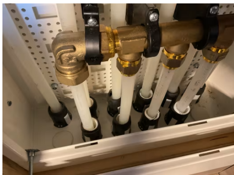
Manglende avrenning fra fordelerskap.
