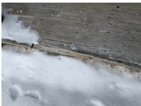
Skade i terrassebord.
