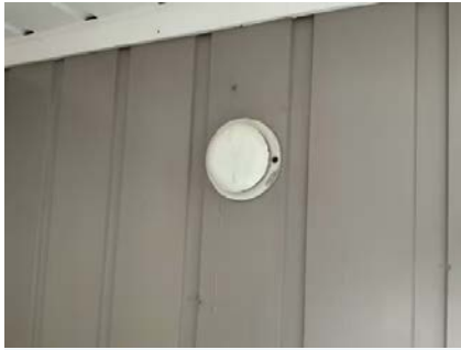
Ventiler i vegg.
