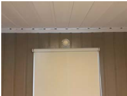
Ventiler i vegg.
