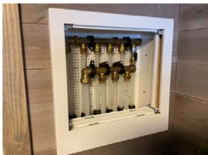
Fordelerskap til vann.
