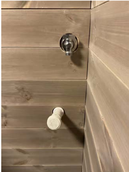
Manglende tetting rundt rør.
