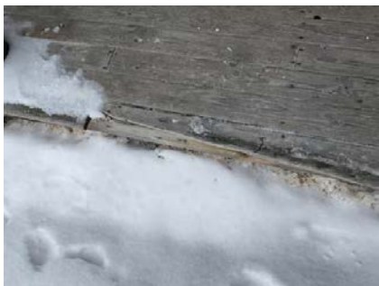
Skade i terrassebord.
