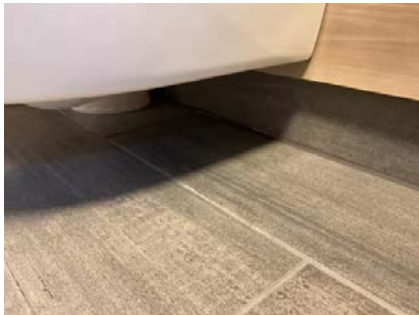
Manglende drengåpning for lekkasjevann fra wc.
