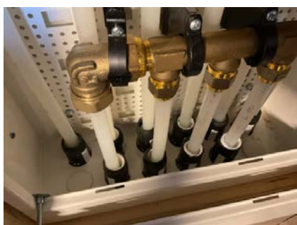
Manglende avrenning fra fordelerskap.
