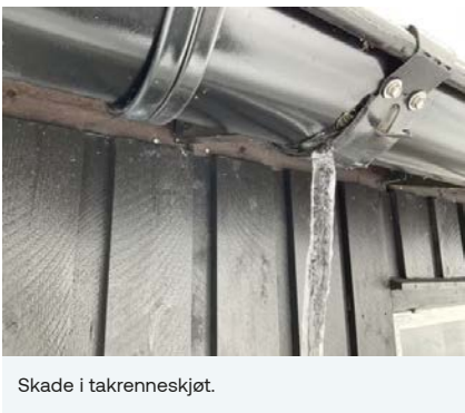
Skade i takrenneskjøt.
