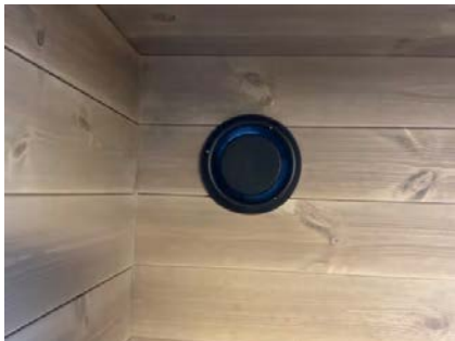
Ventil i vegg.
