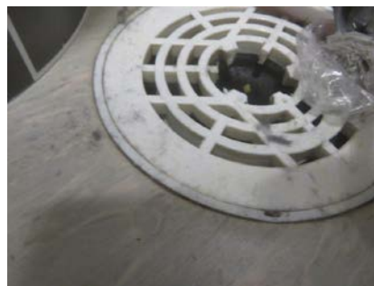
Bildet viser sluk på teknisk rom.
