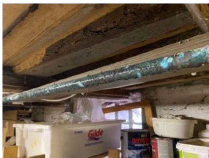
Irr på vannrør i kjeller
