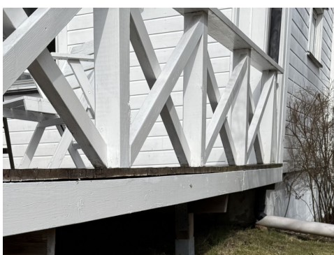
Store åpninger i rekkverk.
