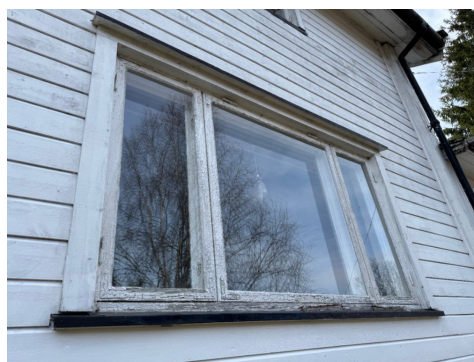
Værslitte dobbeltvinduer av eldre dato.
