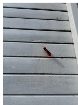
Råteskadet kledning høyere opp på veggen mot sør.
