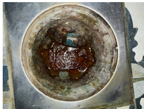
Gammelt sluk og røropplegg
