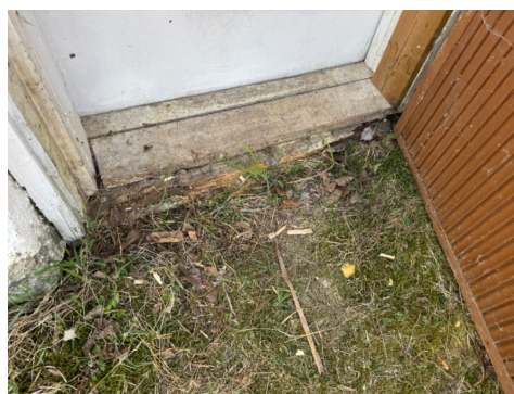
Råteskader i karm/terskel.
