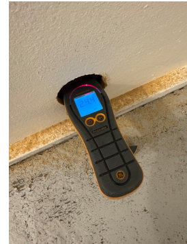
Påvist høye fuktverdier i vegg.
