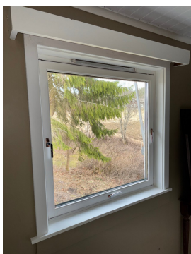
Enkelte vinduer "subber" i karmen.
