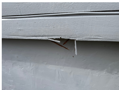
Råteskadet kledning i nedkant
