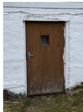
Værslitt og dårlig kjellerdør moden for utskiftning.
