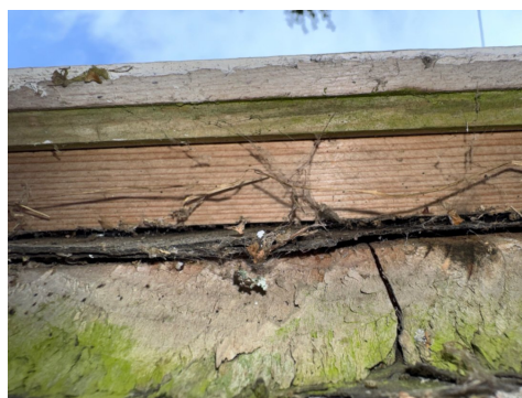
Det er ingen lufting bak kledning.
