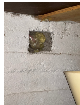
Flere ventiler er tettet med isolasjon.
