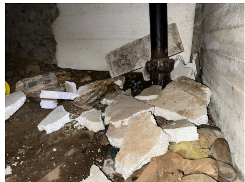
Avløpsrør av gamle støpejernsrør fra bad i krypkjeller
