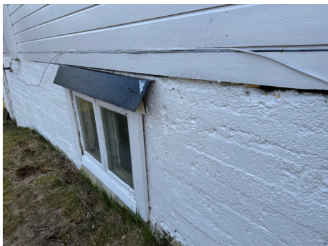
Utvendige beslagsløsninger er ikke fagmessig utført.
