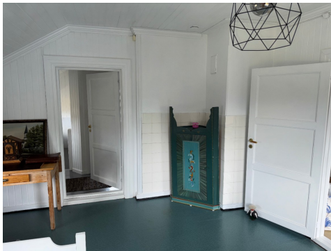
Ca 1/2 part av pipeløp forblendet med fliser på soverom i 2. etg
