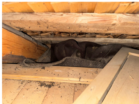
Ingen luftespalter mot raft.
