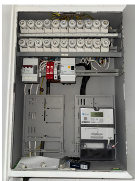
El-skap med gamle skrusikringer
