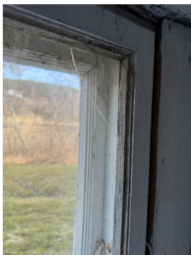
Påvist sprukket glass i kjellervindu
