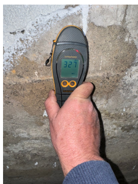
Indikasjon på fuktvandring i murvegger
