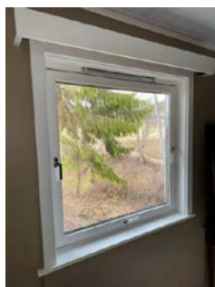
Enkelte vinduer "subber" i karmen.
