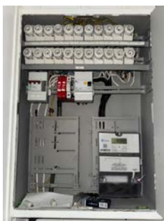
El-skap med gamle skrusikringer
