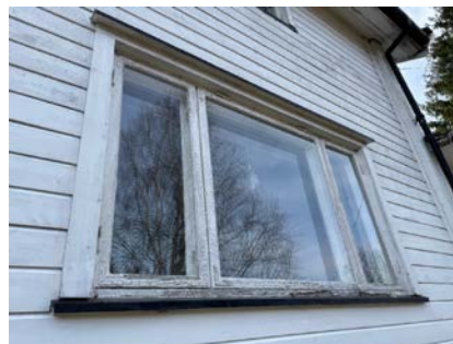
Værslitte dobbeltvinduer av eldre dato.
