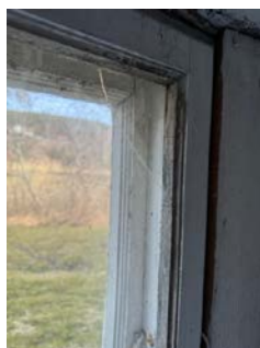
Påvist sprukket glass i kjellervindu
