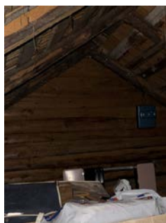
Ingen påvist ventilering av takkonstruksjonen, (ingen lufteluker i gavlsisser).
