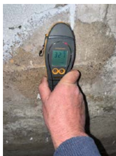
Indikasjon på fuktvandring i murvegger
