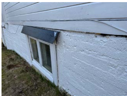
Utvendige beslagsløsninger er ikke fagmessig utført.
