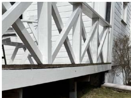
Store åpninger i rekkverk.
