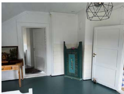
Ca 1/2 part av pipeløp forblendet med fliser på soverom i 2. etg
