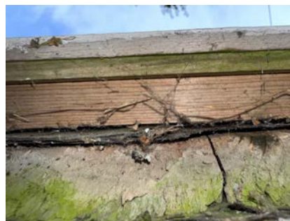
Det er ingen lufting bak kledning.
