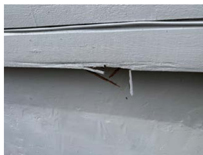
Råteskadet kledning i nedkant
