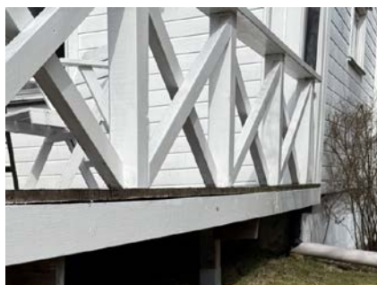
Store åpninger i rekkverk.
