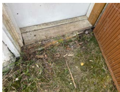
Råteskader i karm/terskel.
