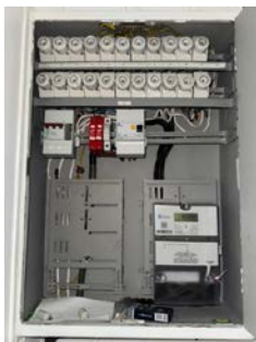
El-skap med gamle skrusikringer
