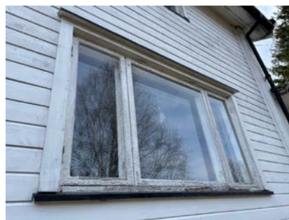
Værslitte dobbeltvinduer av eldre dato.
