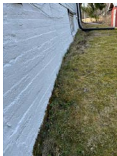
Ingen synlig fuktsperre på grunnmurer eller kjellervegger.
