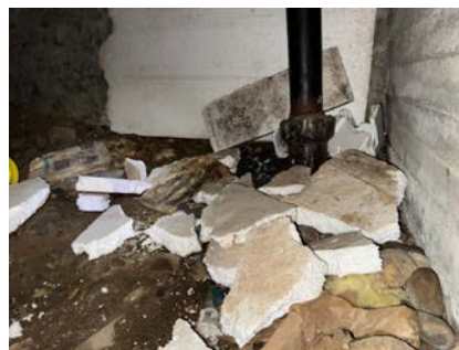
Avløpsrør av gamle støpejernsrør fra bad i krypkjeller
