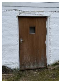
Værslitt og dårlig kjellerdør moden for utskiftning.
