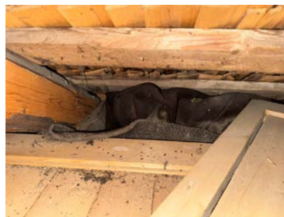
Ingen luftespalter mot raft.
