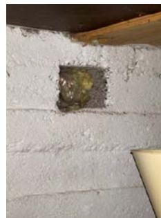
Flere ventiler er tettet med isolasjon.
