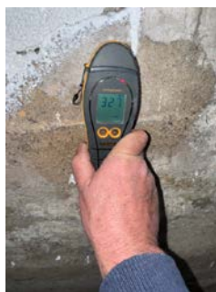
Indikasjon på fuktvandring i murvegger
