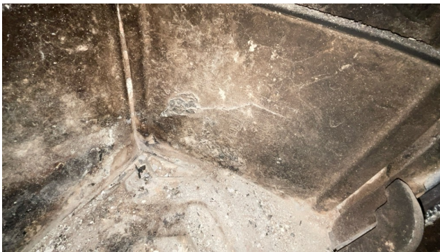
Riss/sprekk i ildfast stein inni ovn.
