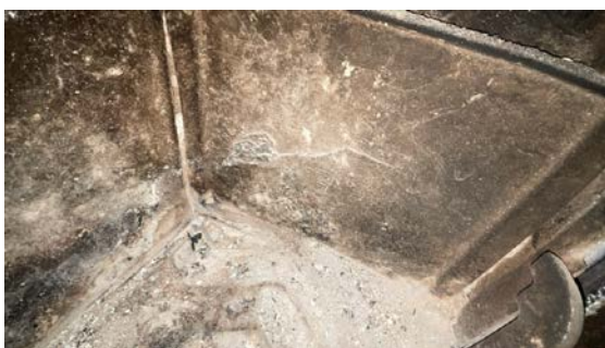
Riss/sprekk i ildfast stein inni ovn.
