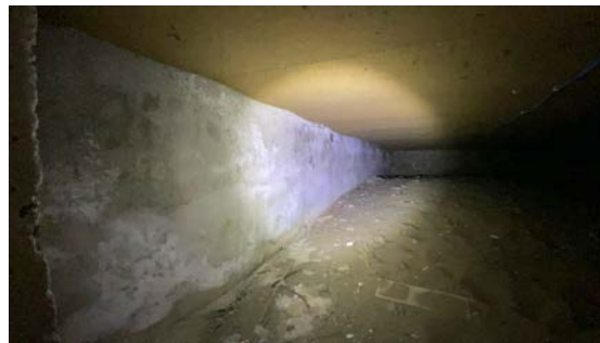
Krypkjeller. Det er ikke synlige ventilert i ringmur.
