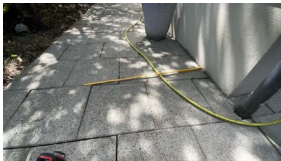
Terreng har fall inn mot grunnmur.
