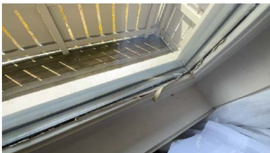
Merker etter kondens i vinduskarm.
