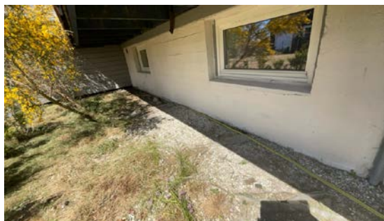
Det er ikke synlig grunnmursplast over terreng.
