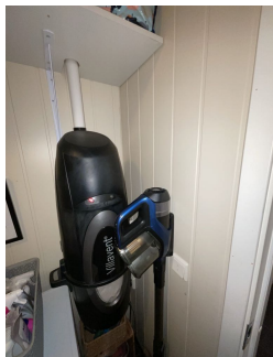
Oversikt sentralstøvsuger på teknisk rom
