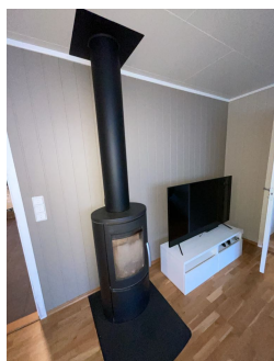
Vedovn på stue med synlig stålpipes
