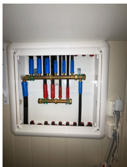
Rørfordelingsskap med merking på hver kurs
