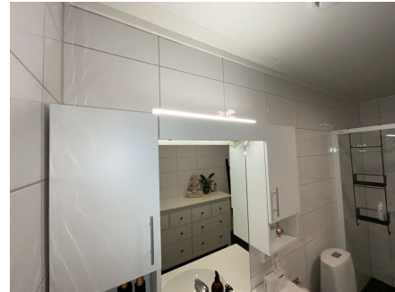
Lysarmatur på bad lyser ikke og det er lagt en løs lysarmatur over som er tilkoblet stikkontakt. Selger får skifta lysarmatur før visning.
