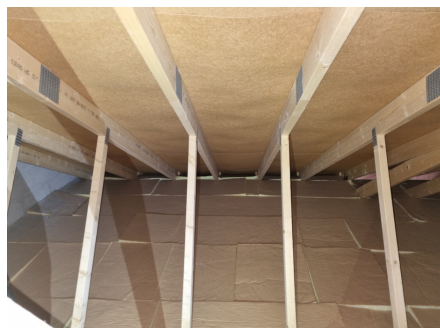
Synlig luftespalte på loft mot raftekasse over boligdelen
