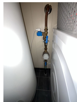
Hovedstoppekrane, vannmåler og vannstoppventil
