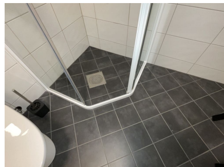
Hovedsluk er plassert inne i dusj.
