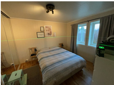
1. etasje Plassering av laser ved kontroll av soverom 2. Det er målt 3 mm høydeforskjell gjennom rommet. TG 1
