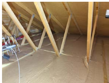
Ingen synlige luftespalter på loft mot raftekasse over isolert lagerrom ved garasje
