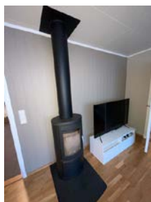
Vedovn på stue med synlig stålpipes
