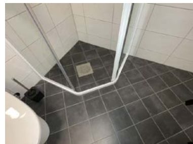
Hovedsluk er plassert inne i dusj.
