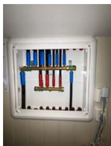
Rørfordelingsskap med merking på hver kurs
