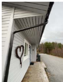
Synlige luftespalter i raftekasse ved overgang tak/vegg på garasje og boligdelen
