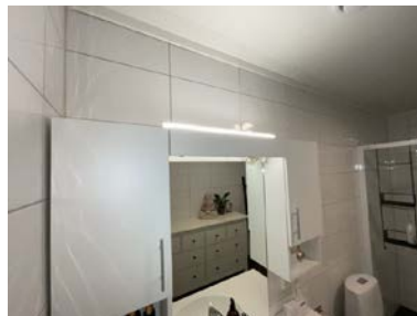
Lysarmatur på bad lyser ikke og det er lagt en løs lysarmatur over som er tilkoblet stikkontakt. Selger får skifte lysarmatur før visning.
