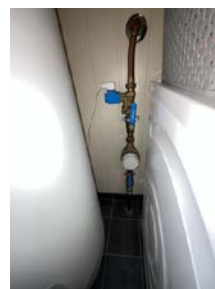
Hovedstoppekrane, vannmåler og vannstoppventil
