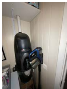
Oversikt sentralstøvsuger på teknisk rom
