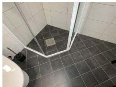
Hovedsluk er plassert inne i dusj.
