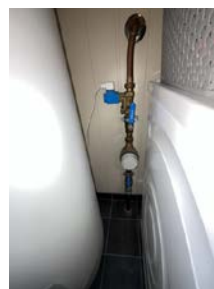
Hovedstoppekrane, vannmåler og vannstoppventil
