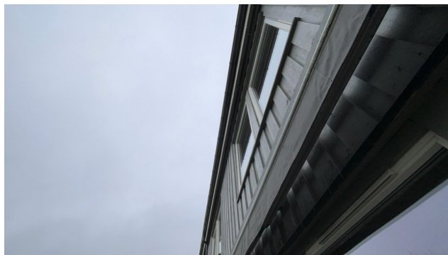
Synlige luftespalter i gesimskasse.
