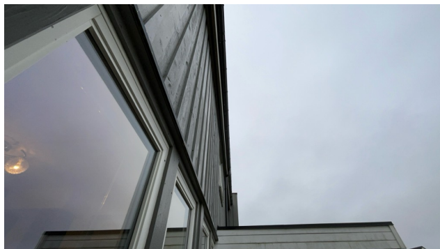
Synlige luftespalter i gesimskasse.
