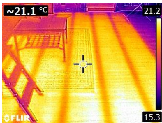
Bilde 5 Her fremgår det av termogrammet at varmemefolien ikke dekker hele rommets areal.
