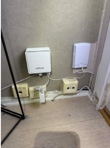
Bilde 1 Fiber-inntak og konverter.
