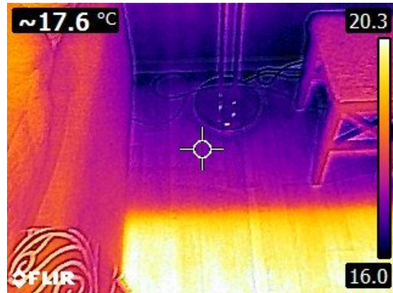
Bilde 2 Her fremgår det av termogrammet at deler av varmemefolien dekker noe innenfor bod.
