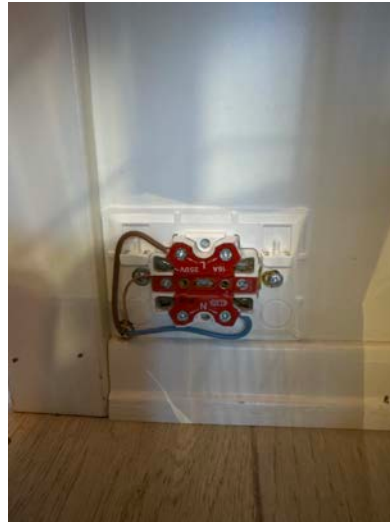
Bilde 2 Stikkontakt ved spisebordet.
