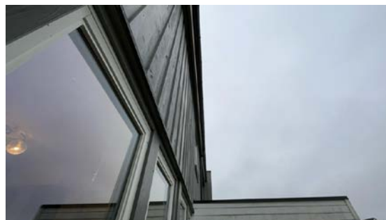
Synlige luftespalter i gesimskasse.
