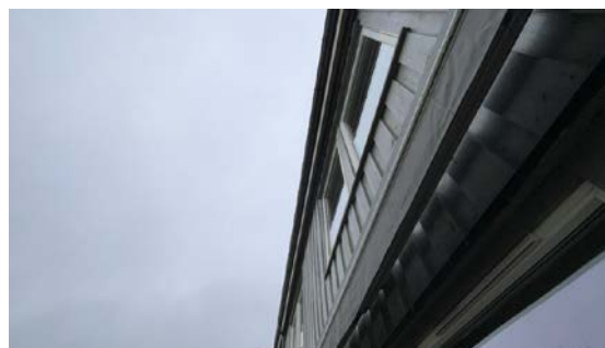
Synlige luftespalter i gesimskasse.
