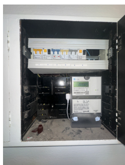
Sikringsskap med automatsikringer.
