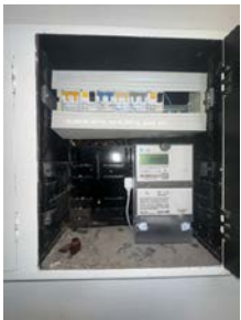
Sikringsskap med automatsikringer.
