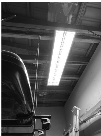
Bilde 2 Eldre lysarmaturer i garasje/verksted og kjeller anbefales å skiftes ut.
