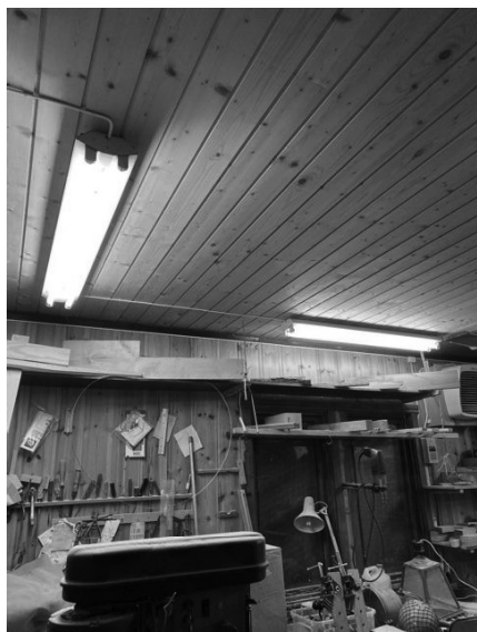
Bilde 1 Eldre lysarmaturer i garasje/verksted og kjeller anbefales å skiftes ut.
