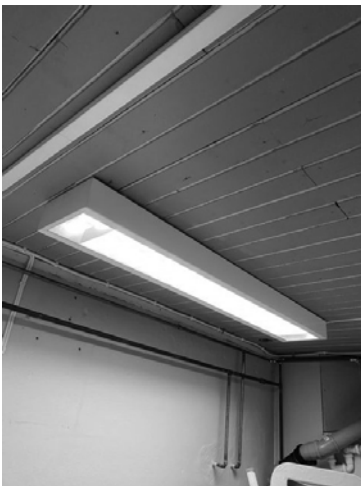
Bilde 3 Eldre lysarmaturer i garasje/verksted og kjeller anbefales å skiftes ut.
