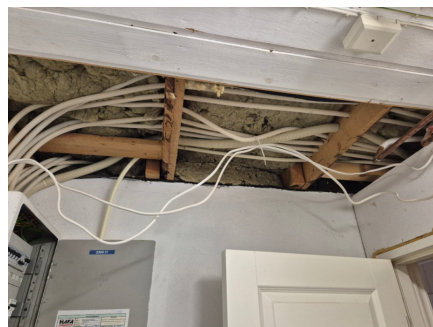
Ledninger er ikke tilstrekkelig festet.
