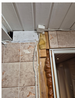
Ledninger er ikke tilstrekkelig festet.
