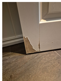
Skade på dør mellom gang og bod/kontor.
