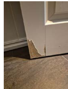
Skade på dør mellom gang og bod/kontor.
