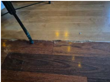
Skader på laminatgulv i stue.
