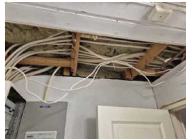
Ledninger er ikke tilstrekkelig festet.
