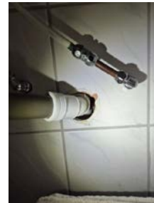
Utette rørgjennomføringer under vask.
