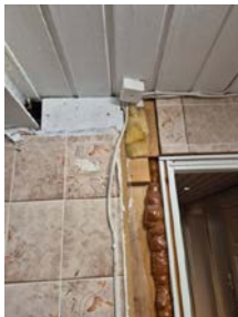
Ledninger er ikke tilstrekkelig festet.
