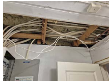
Ledninger er ikke tilstrekkelig festet.
