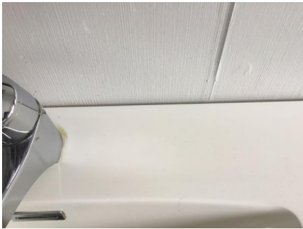
Manglende fuge mellom servant og vegg.
