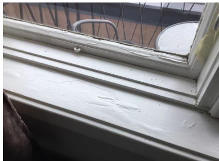
Kondensmerker på flere vinduer.
