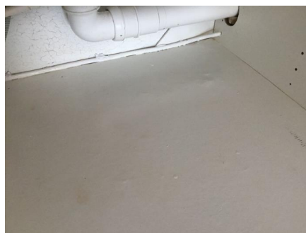
Svelling på innredning.
