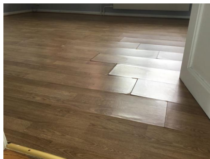
Fuktskade på gulv på soverom.
