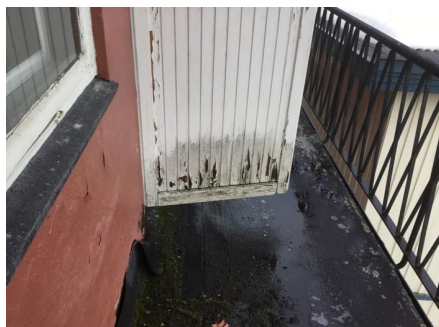
Råteskade på balkongdør.
