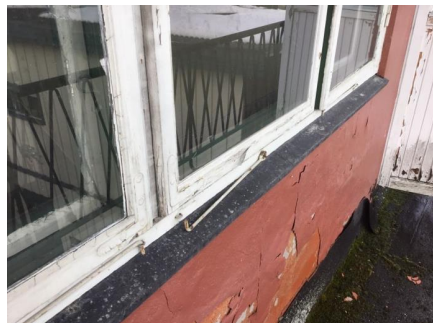
Slitasje/sprekker på flere vinduer.
