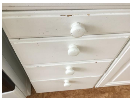
Slitasje på overflater.
