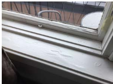
Kondensmerker på flere vinduer.
