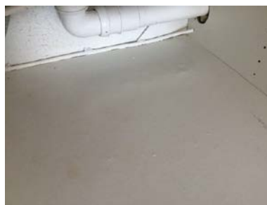
Svelling på innredning.
