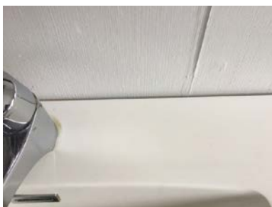
Manglende fuge mellom servant og vegg.
