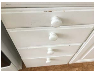
Slitasje på overflater.
