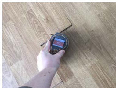
Ved enkle fuktsøk ble det registrert fukt.
