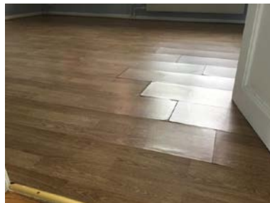
Fuktskade på gulv på soverom.
