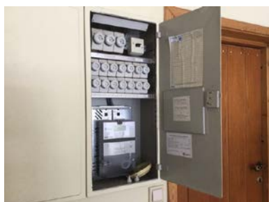
Sikringsskap plassert i felles gang.
