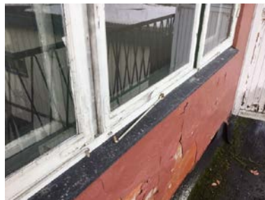
Slitasje/sprekker på flere vinduer.
