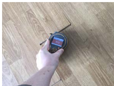
Ved enkle fuktsøk ble det registrert fukt.
