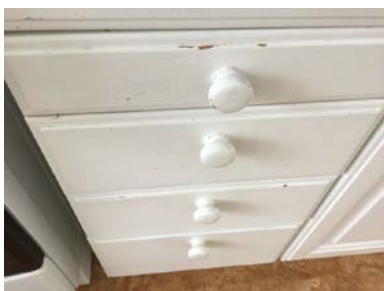
Slitasje på overflater.
