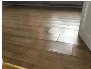
Fuktskade på gulv på soverom.
