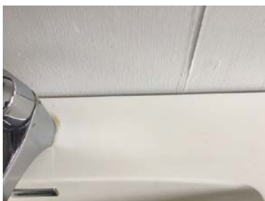
Manglende fuge mellom servant og vegg.
