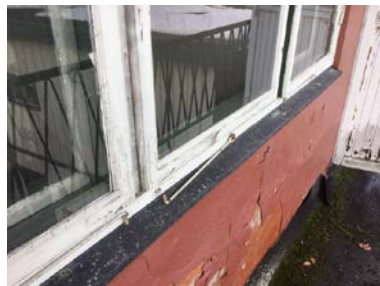
Slitasje/sprekker på flere vinduer.
