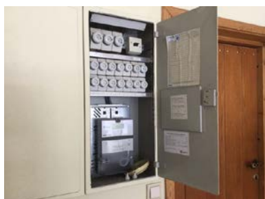
Sikringsskap plassert i felles gang.
