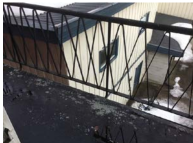
Rekkverk felles balkong.
