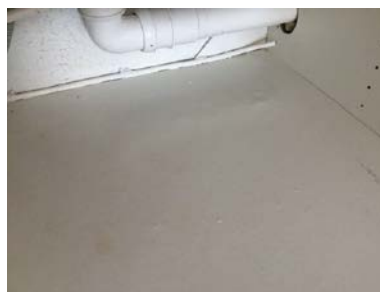
Svelling på innredning.
