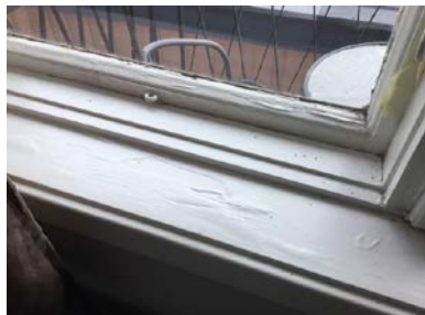
Kondensmerker på flere vinduer.
