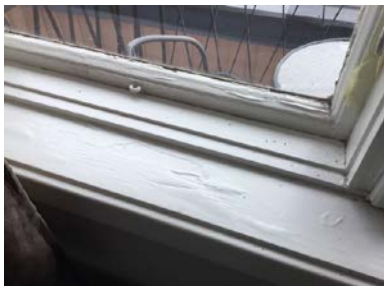
Kondensmerker på flere vinduer.
