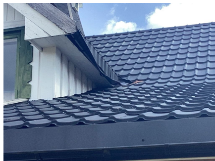
Skade på takrenne.
