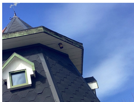
Råteskade på tak på tårn.
