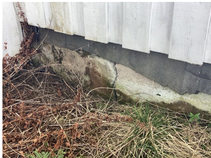
Eksempel på sprekk i grunnmur.
