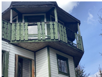
Råteskader i rekkverkskledning og manglende rekkverkskledning.
