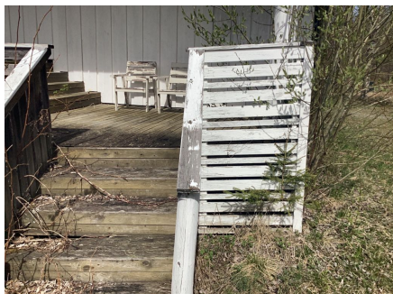
Råteskader i bjelker i dette området.
