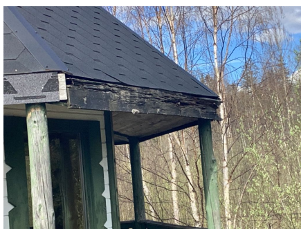
Råteskade på tak på tårn.
