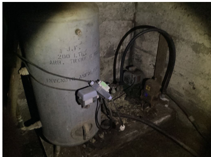
Defekt vannpumpe og trykktank
