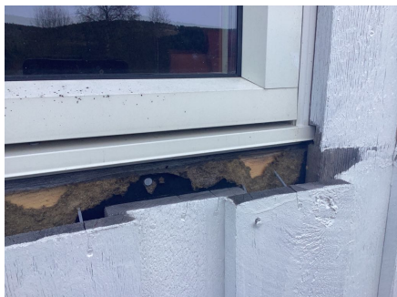
Manglende vannbrett under vindu mot vest.
