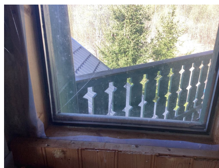
Sprekk i flere glass.
