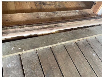
Det er ikke beslag under dør mot sør.
