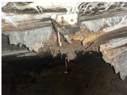
Råteskade i kryperom.
