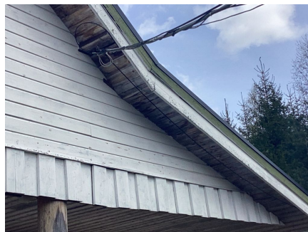
Misfarging og svertesopp i takutstikk.
