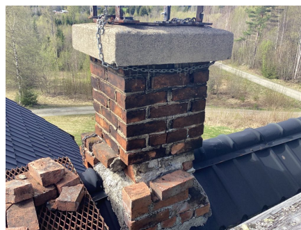
Oppsprekking i fuger på pipe over tak.
