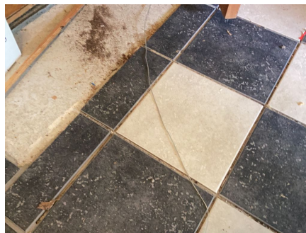
Eksempel på uferdig gulvlegging.
