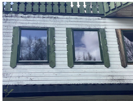
Vinduer uten vannbrett.
