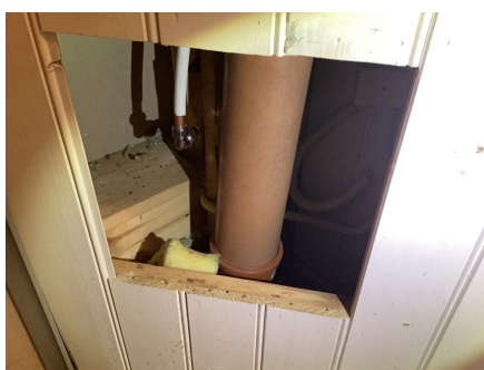
Eksempel på avløpsrør med skjult føring.
