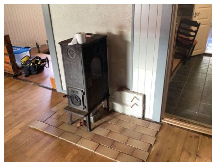
Enkelte løse fliser på gulv i 1. etasje.
