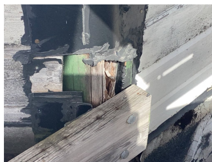
Råteskade i veggstokk. Dette kan også finnes flere steder rundt tårnet.
