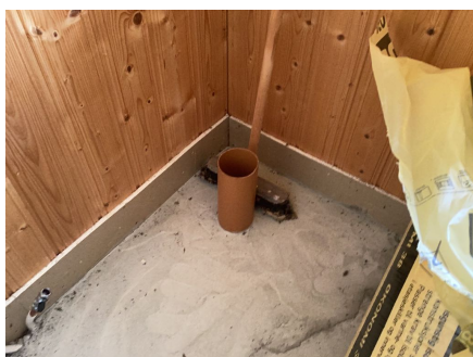
Eksempel på ukoblet ende på avløpsrør.
