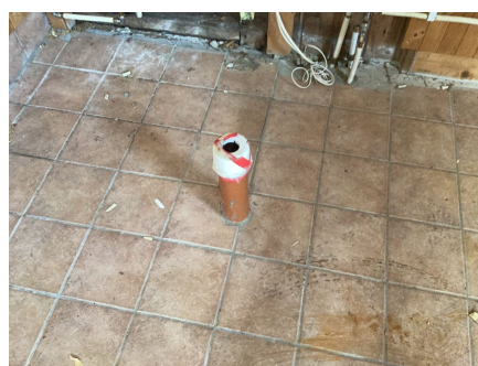
Eksempel på ukoblet ende på avløpsrør.
