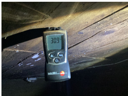
Skadelig fuktinnhold i treverk i kjelleren.
