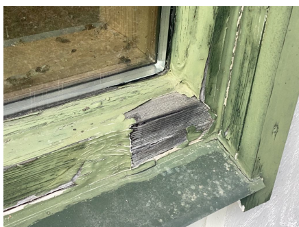
Eksempel på slitasje.
