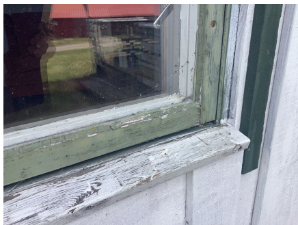
Eksempel på slitasje.
