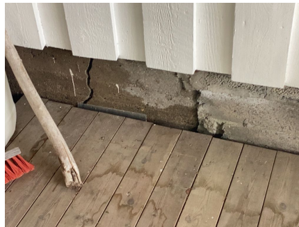
Eksempel på sprekk i grunnmur.
