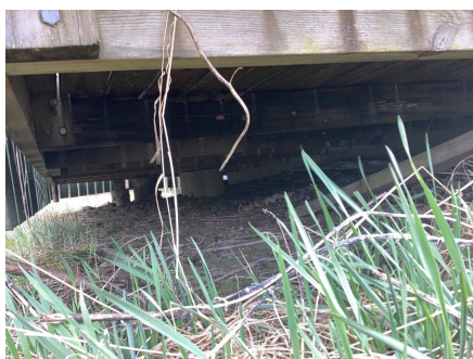
Råteskader i flere bjelker mot nord.
