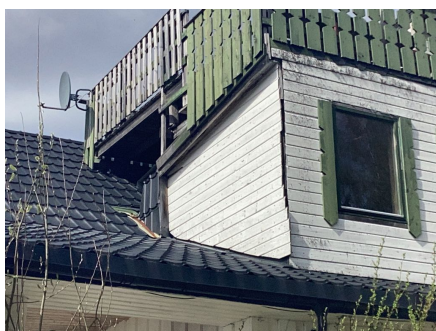
Vegg kledd med takplate og manglende hjørnekasse.
