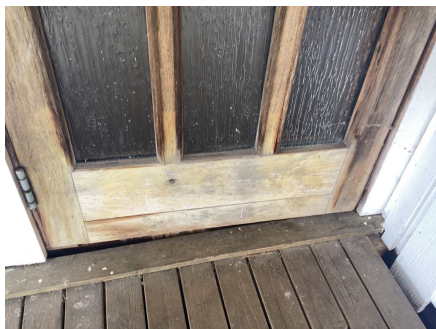
Slitasje på entredør mot sør.
