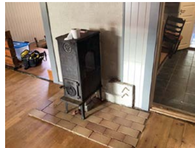
Enkelte løse fliser på gulv i 1. etasje.
