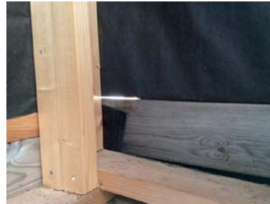
Utett gjennom yttervegg i tårnetasjen.
