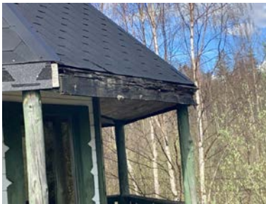
Råteskade på tak på tårn.
