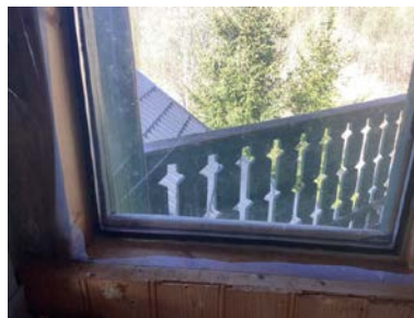
Sprekk i flere glass.
