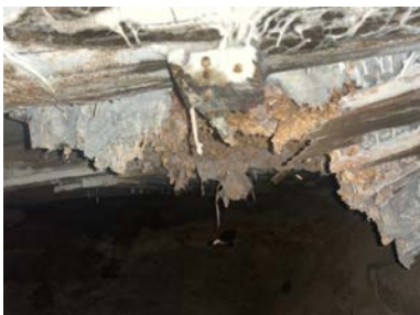
Råteskade i kryperom.
