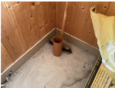
Eksempel på ukoblet ende på avløpsrør.
