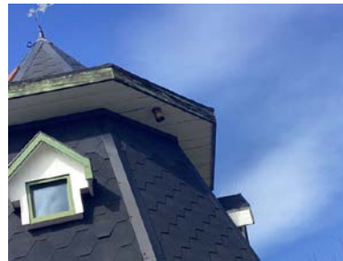
Råteskade på tak på tårn.
