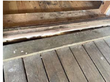
Det er ikke beslag under dør mot sør.
