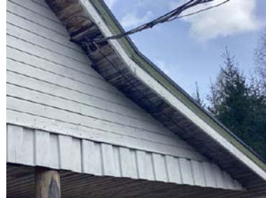
Misfarging og svertesopp i takutstikk.
