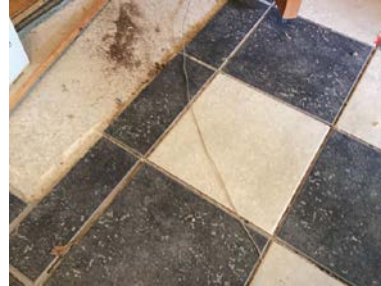
Eksempel på uferdig gulvlegging.
