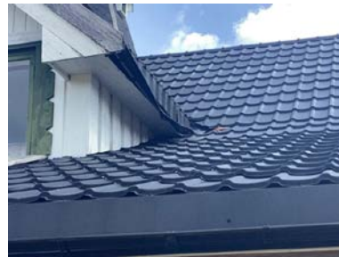
Skade på takrenne.
