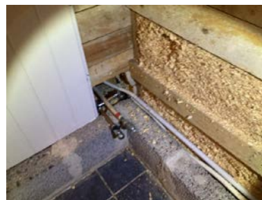
Eksempel på løse ender på vannrør.
