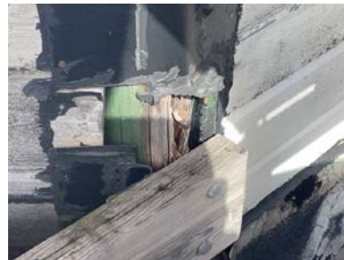
Råteskade i veggstokk. Dette kan også finnes flere steder rundt tårnet.
