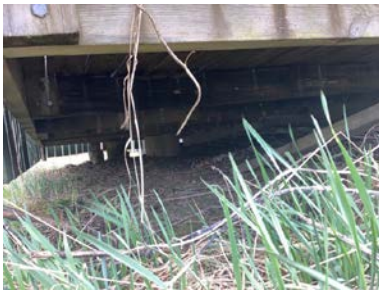
Råteskader i flere bjelker mot nord.
