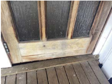
Slitasje på entredør mot sør.
