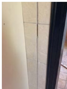
Eksempel på oppsprekking i fuger.
