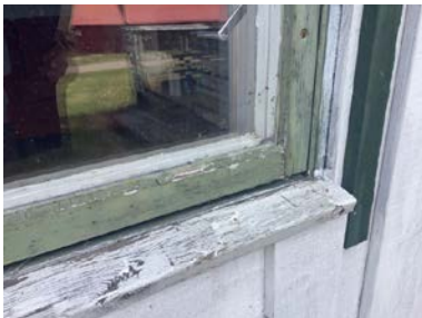
Eksempel på slitasje.
