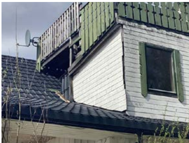
Vegg kledd med takplate og manglende hjørnekasse.
