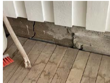
Eksempel på sprekk i grunnmur.
