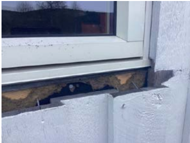
Manglende vannbrett under vindu mot vest.
