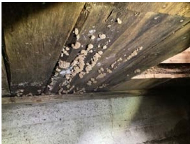
Soppvekst på treverk flere steder.
