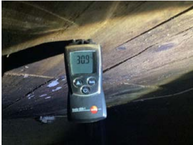
Skadelig fuktnivå i treverk i kjelleren.
