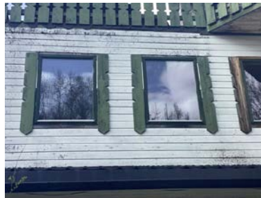
Vinduer uten vannbrett.
