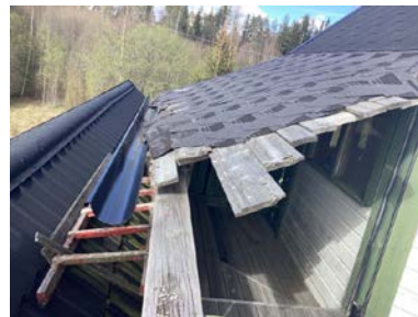
Uferdig takrenne på skjermetak på balkong på tårn.
