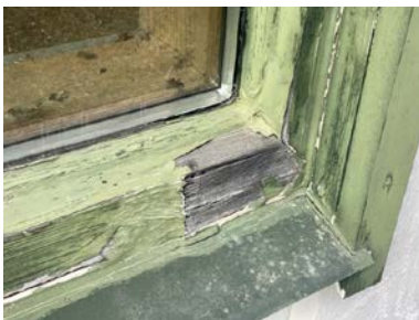
Eksempel på slitasje.
