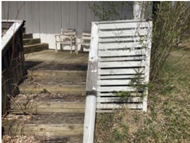
Råteskader i bjelker i dette området.
