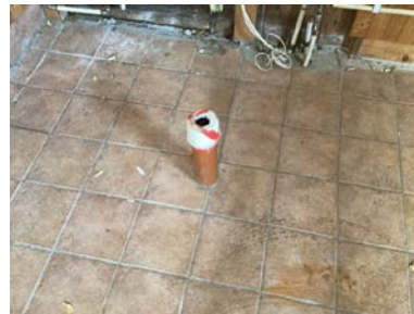
Eksempel på ukoblet ende på avløpsrør.
