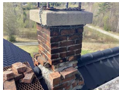
Oppsprekking i fuger på pipe over tak.
