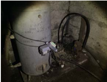
Defekt vannpumpe og trykktank
