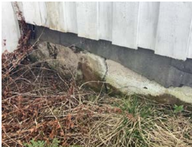
Eksempel på sprekk i grunnmur.
