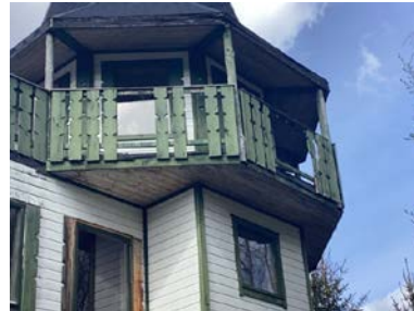
Råteskader i rekkverkskledning og manglende rekkverkskledning.
