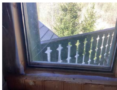
Sprekk i flere glass.
