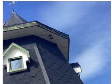
Råteskade på tak på tårn.
