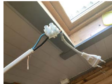
Eksempel på utførelse som indikerer arbeid av ufaglært.
