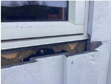
Manglende vannbrett under vindu mot vest.
