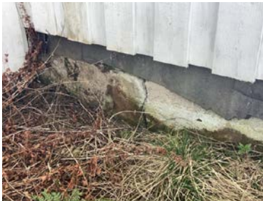
Eksempel på sprekk i grunnmur.
