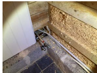
Eksempel på løse ender på vannrør.
