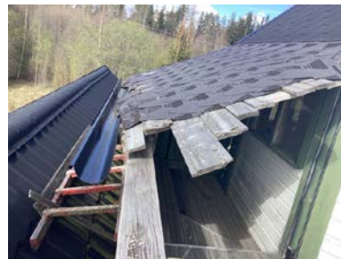
Uferdig takrenne på skjermtak på balkong på tårn.
