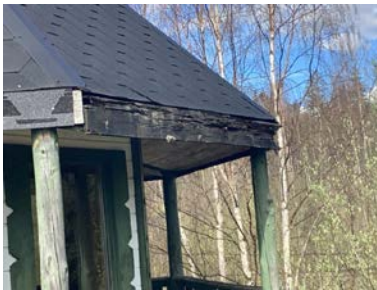
Råteskade på tak på tårn.
