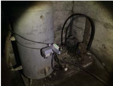
Defekt vannpumpe og trykktank
