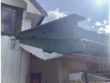
Eksempel på råte på vindski.
