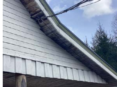
Misfarging og svertesopp i takutstikk.
