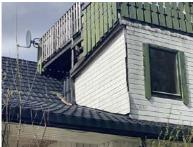
Vegg kledd med takplate og manglende hjørnekasse.
