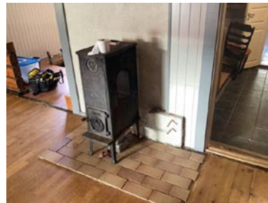
Enkelte løse fliser på gulv i 1. etasje.
