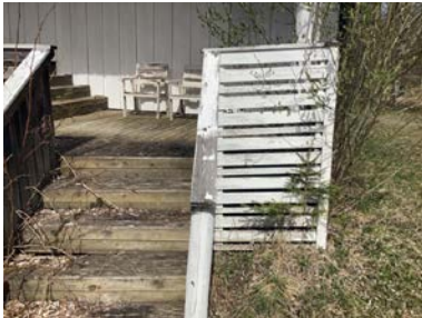
Råteskader i bjelker i dette området.
