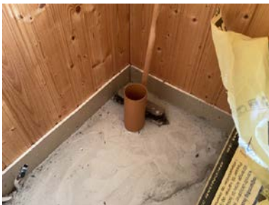
Eksempel på ukoblet ende på avløpsrør.
