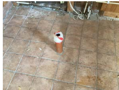
Eksempel på ukoblet ende på avløpsrør.
