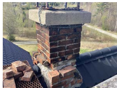
Oppsprekking i fuger på pipe over tak.
