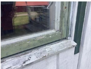
Eksempel på slitasje.
