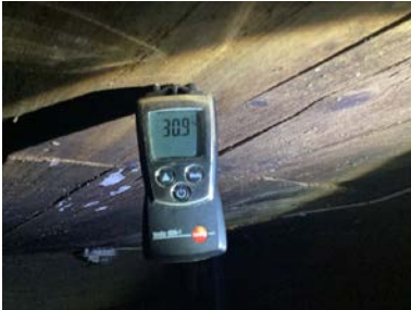
Skadelig fuktnivå i treverk i kjelleren.
