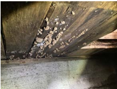
Soppvekst på treverk flere steder.
