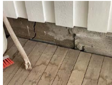
Eksempel på sprekk i grunnmur.
