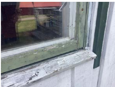
Eksempel på slitasje.
