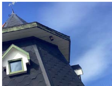
Råteskade på tak på tårn.
