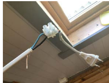
Eksempel på utførelse som indikerer arbeid av ufaglært.
