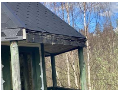
Råteskade på tak på tårn.
