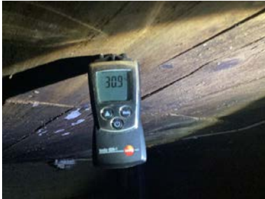
Skadelig fuktnivå i treverk i kjelleren.
