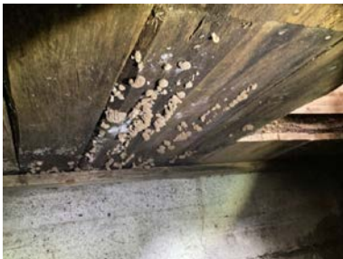
Soppvekst på treverk flere steder.
