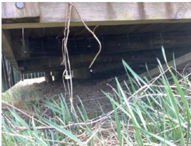
Råteskader i flere bjelker mot nord.
