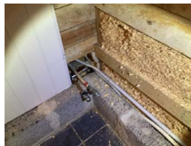
Eksempel på løse ender på vannrør.
