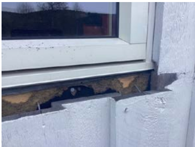
Manglende vannbrett under vindu mot vest.
