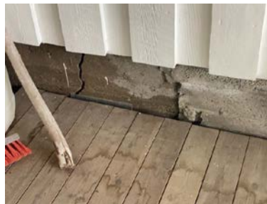
Eksempel på sprekk i grunnmur.
