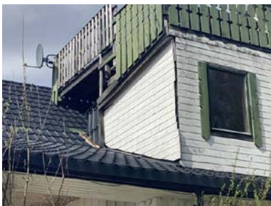
Vegg kledd med takplate og manglende hjørnekasse.
