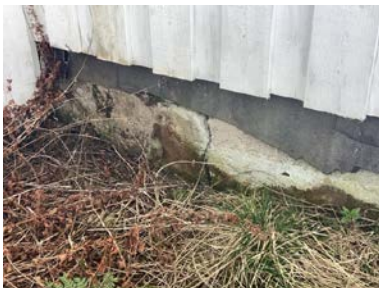
Eksempel på sprekk i grunnmur.
