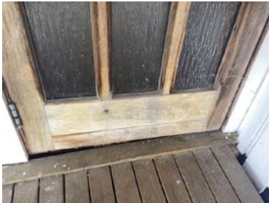
Slitasje på entredør mot sør.
