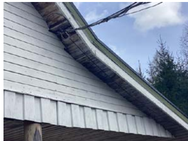
Misfarging og svertesopp i takutstikk.
