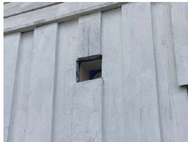
Det mangler stedvis ventiler på utsparinger i fasadekledning.
