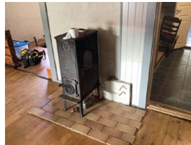
Enkelte løse fliser på gulv i 1. etasje.
