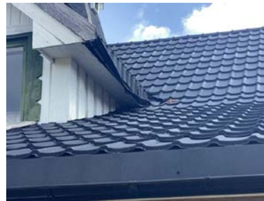
Skade på takrenne.
