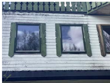
Vinduer uten vannbrett.
