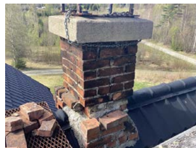
Oppsprekking i fuger på pipe over tak.
