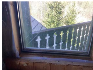
Sprekk i flere glass.
