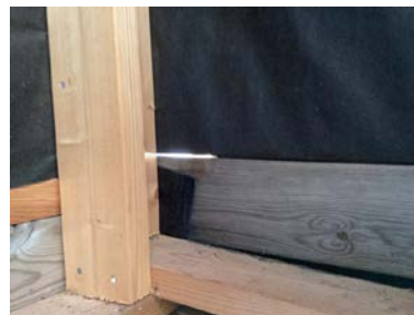
Utett gjennom yttervegg i tårnetasjen.
