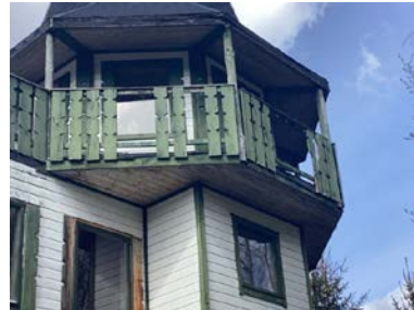
Råteskader i rekkverkskledning og manglende rekkverkskledning.
