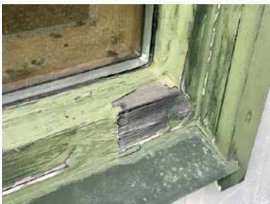
Eksempel på slitasje.
