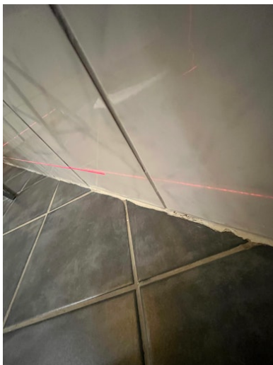
Ujevn silikon i overgang gulv/vegg
