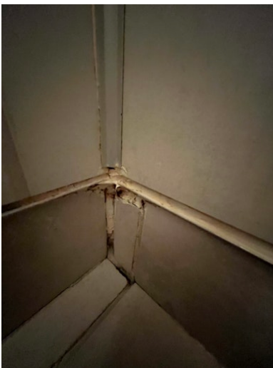
Avvik på utførelse
