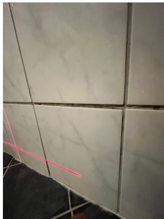
Noe lav fylling på fuger med sement fugemasse / porer
