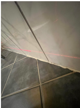
Ujevn silikon i overgang gulv/vegg
