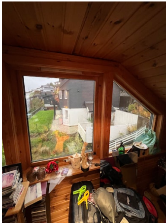
Målt høy fuktighet i nedre hjørne på vindu
