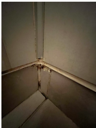
Avvik på utførelse
