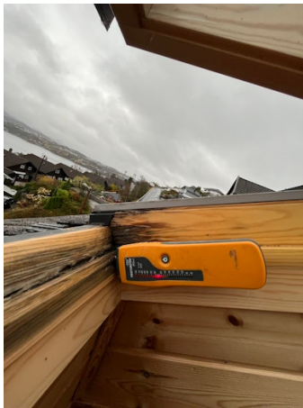
Målt høy fuktighet i nedre hjørne på takvindu.
