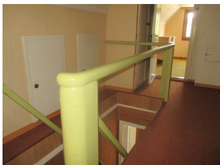
Rekkverk må tettes med tanke på sikkerhet.
