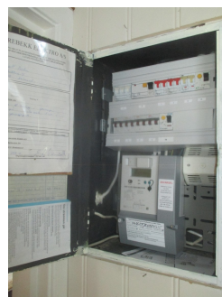
Sikringsskapet er plassert i gangen.
