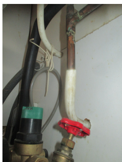
Deler av rør med en stoppekran i kjøkkenbenken.
