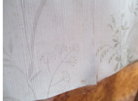
Tapet har løsnet flere plasser
