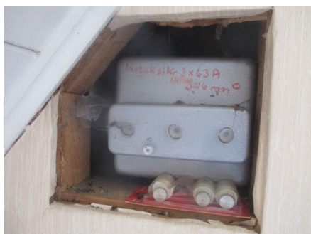
Hovedinntaket på loftet.
