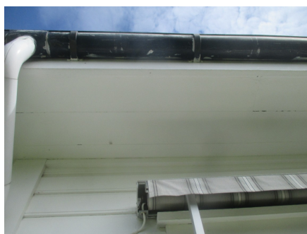
Ingen luftespalter i gesimser for lufting av lukket takkonstruksjon.
