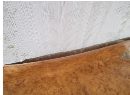
Gulvbelegget har løsnet ved oppkant
