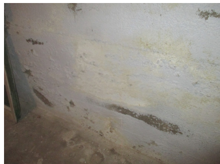
Fuktvandring ved søk direkte på grunnmur
