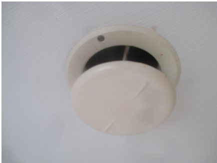
Ventil i himling med naturlig avtrekk.
