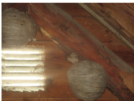
To større vepsebol på kaldtloft opprinnlig del.
