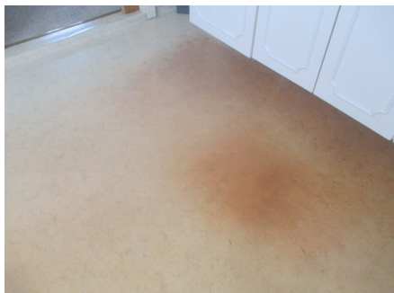
Misfarging på gulvbelegget
