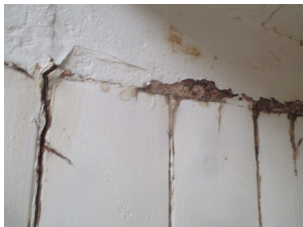
Eldre lekkasjer i rundt pipe.
