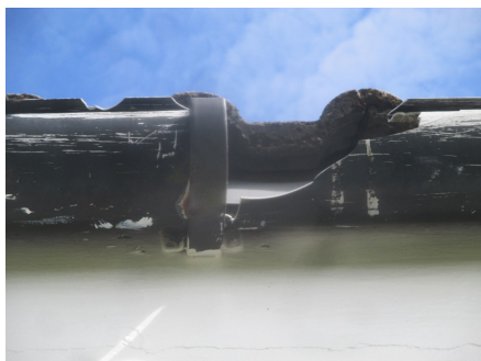
Større skade på del av takrenne.
