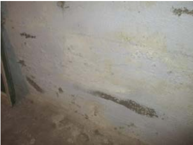
Fuktvandring ved søk direkte på grunnmur
