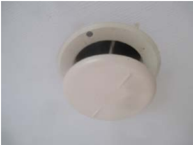
Ventil i himling med naturlig avtrekk.
