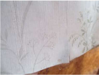
Tapet har løsnet flere plasser
