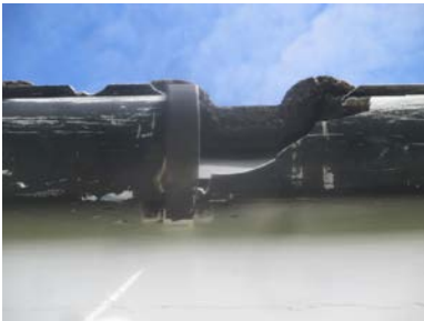
Større skade på del av takrenne.
