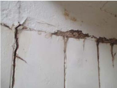
Eldre lekkasjer i rundt pipe.
