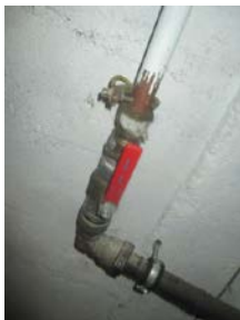
Innvendig hoved stoppekran i grovkjeller
