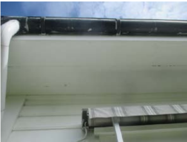
Ingen luftespalter i gesimser for lufting av lukket takkonstruksjon.
