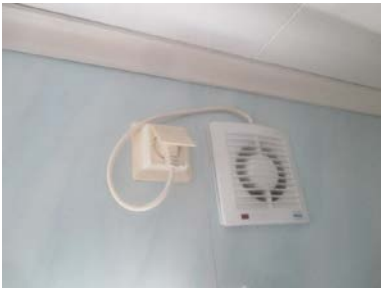
Vifte i ytterveggen.
