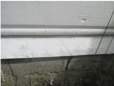
Lite/ingen tilgang på luft i mot grunnmur bak kledningen.
