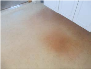
Misfarging på gulvbelegget
