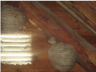
To større vepsebol på kaldtloft opprinnlig del.
