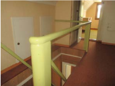
Rekkverk må tettes med tanke på sikkerhet.
