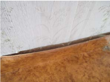
Gulvbelegget har løsnet ved oppkant
