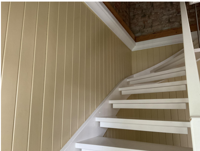
Manglende håndløper på vegg i trappeløp.
