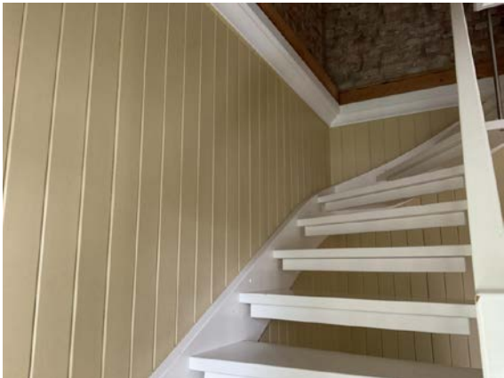
Manglende håndløper på vegg i trappeløp.
