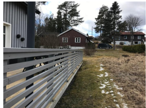
Synlig skjevhet i terrasse.
