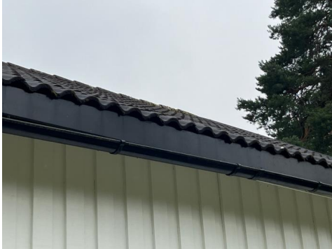
Synlig skjevhet i takkonstruksjon
