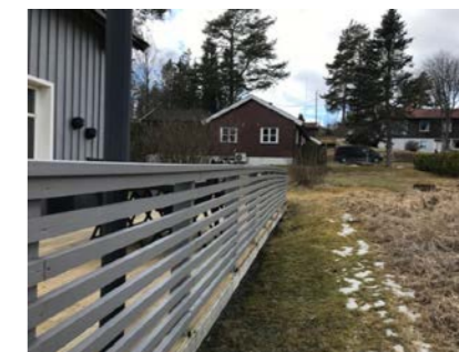
Synlig skjevhet i terrasse.
