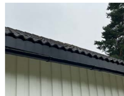
Synlig skjevhet i takkonstruksjon
