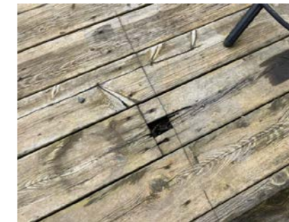
Råteskader i terrassegulv.
