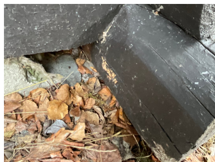
Påvist tegn til råte på nedre tømmerov.
