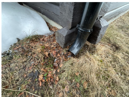
Taknedløp ved samme området som råte er påvist.
