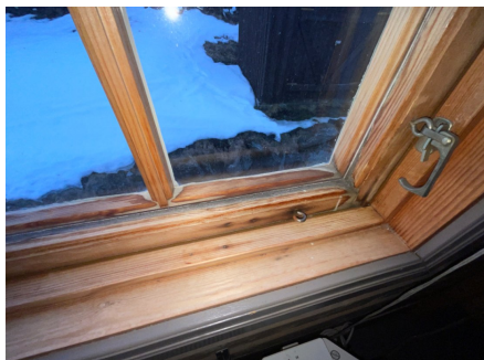
Kondensering på innvendige karmen
