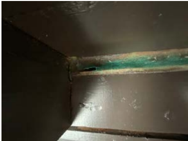
Hull i fluenetting flere steder rundt om takutstikk.
