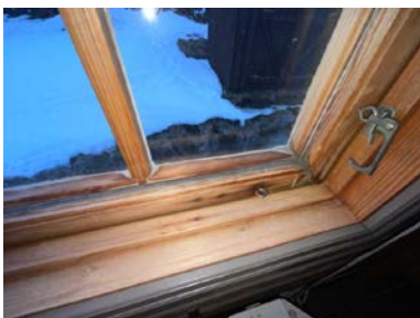
Kondensering på innvendige karmen
