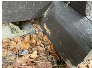
Påvist tegn til råte på nedre tømmerov.
